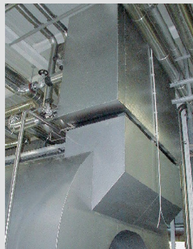
Интегрированный экономайзер, установленный на котле Vitomax 200-HS
