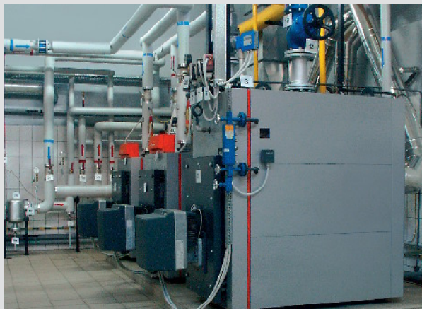
Паровой котел низкого давления Vitoplex 100-LS в эксплуатации.
