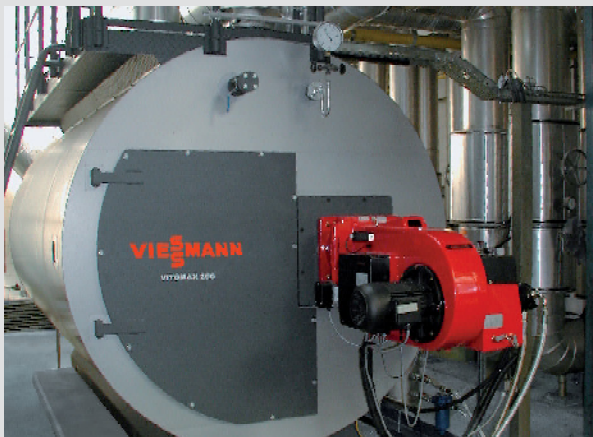
Паровой котел Vitomax 200-HS в эксплуатации.
