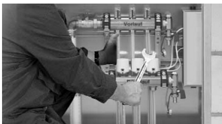
Коллектор Roth с индикатором потока
